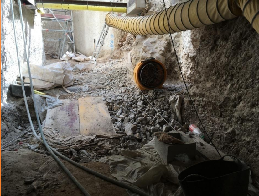
Foto 45. Vista de l'estat del jaciment un cop finalitzades les obres de repicat.
